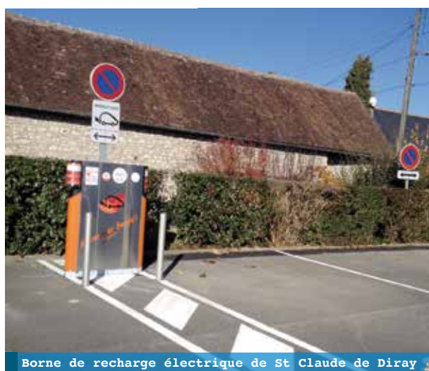
Borne de recharge électrique de St Claude de Diray
